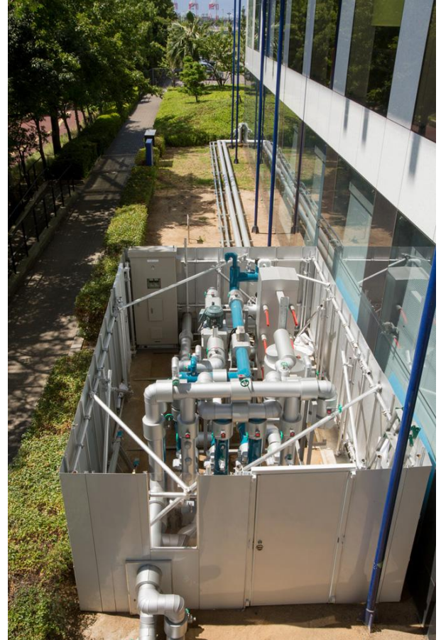
写真3 サーマルルーター（大阪府咲洲庁舎）
